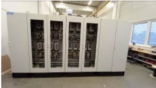
Schaltanlage neu – ©Spörk
